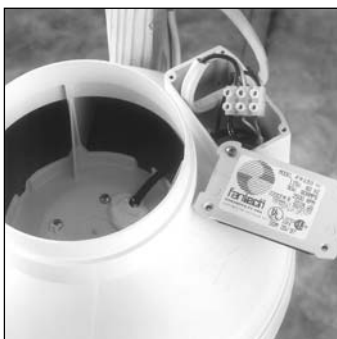
Câblage Romex - Vue de dessus.
